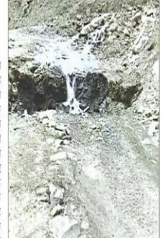
पाहलमो नाला में अंध बाढ़ के कारण धंस सड़क का हिस्सा।
