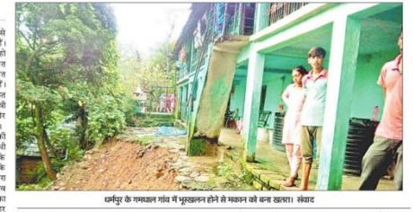
धर्मपुर के मलाणा गांव में भूखंडलन होने से मकान को क्षति हो रही है।
