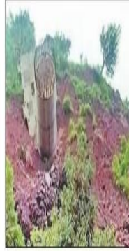
कौरतपुर-नेचोक फ़ास्टेन पर मेहला के समीप निर्माणधीन फ्लाईओवर के गिरे पिलर। संवाद
