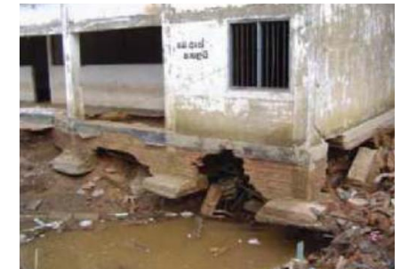
चित्र 2.2.3.6 प्लिंथ के नीचे मिट्टी कटने से नुकसान
